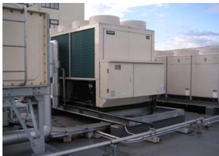
写真8-3 高効率空調機 (外気取り込み型)
