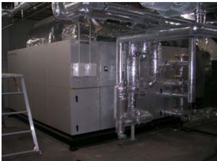
写真8-2 高効率空調機
