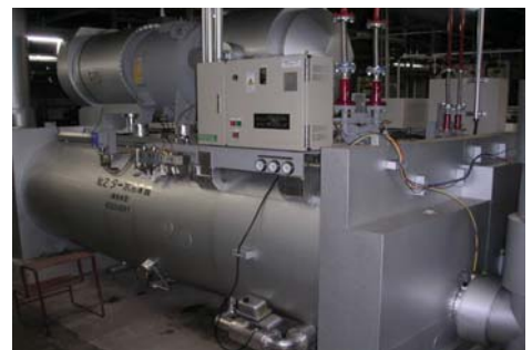
写真8-1 冷水設備（ターボ冷凍機）
