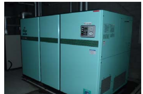
写真8-4 I7コンプレッサ（インバータ化）
