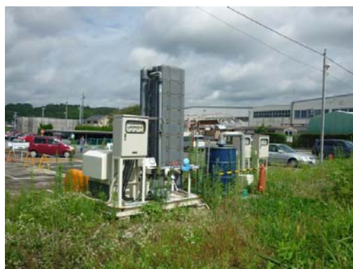
写真 8-6 揚水浄化装置
