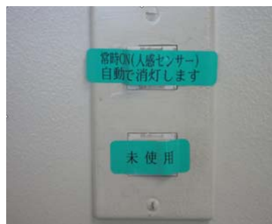
写真6-1 照明スイッチの表示
