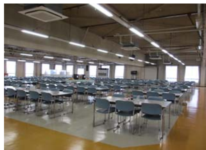
写真6-2 蛍光灯の間引き(食堂)
