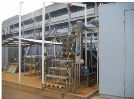
写真6-5 地下水浄化装置
