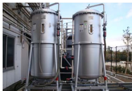
写真6-6 ホウ素キレート樹脂塔 (ホウ素ろ過処理塔)
