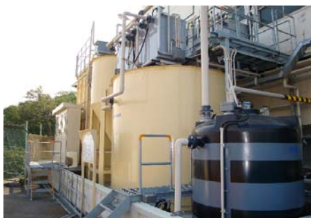
写真6-5 排水処理プラント
